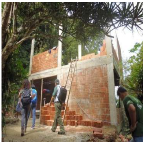
Figura 38 – Obra sem autorização do ICMBio.
